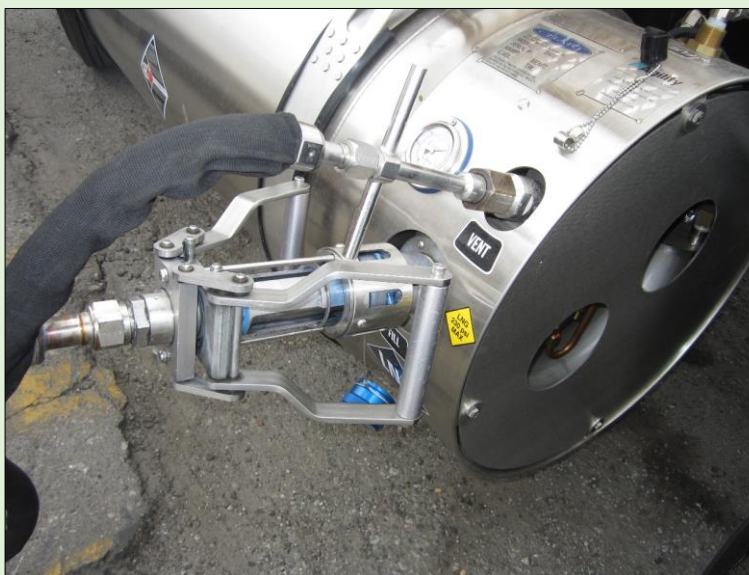
Chart LNG fuel tank (~75 DGE) receiving LNG
